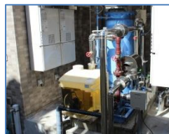
給水ポンプ付近へ
