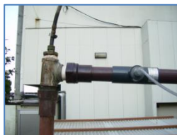
源泉井戸付近の配管へ
