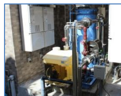
給水ポンプ付近へ
