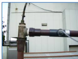
源泉井戸付近の配管へ
